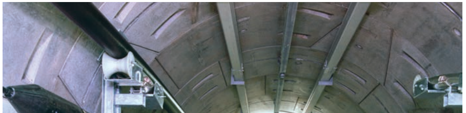
Rails inserts Halfen incurvés dans les segments de tunnel
