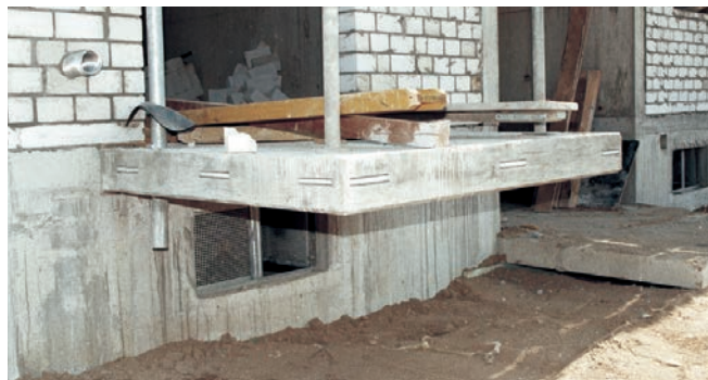
Ancrages pour garde-corps, immeuble résidentiel
