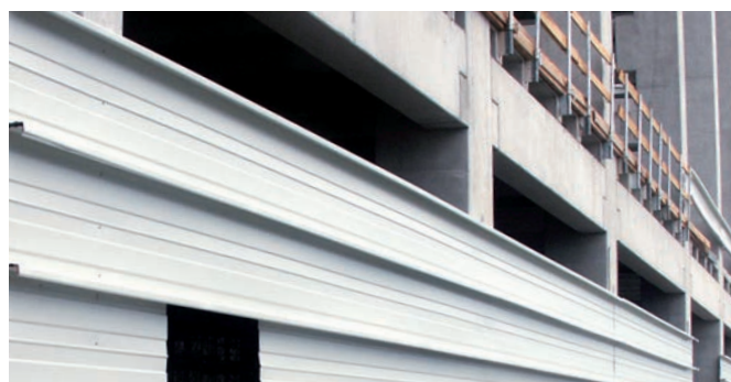
Revêtement de façade réalisé à l'aide de rails de fixation Halfen HTU (aéroport de Cologne Bonn)
