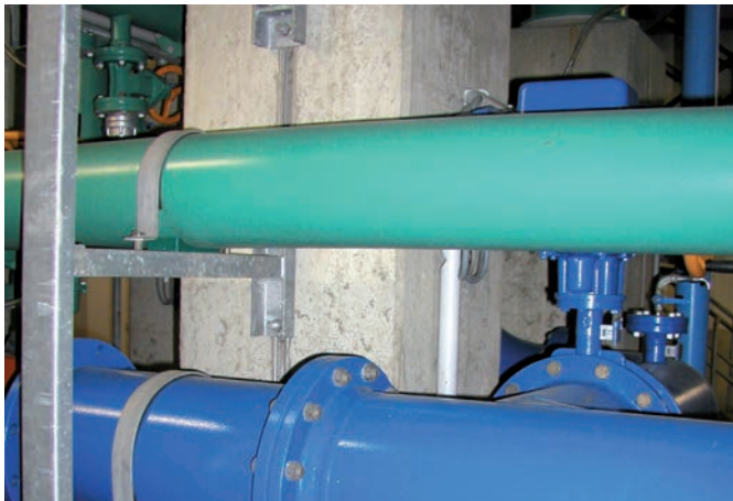
Supports de tuyauterie sur rails HZA verticaux
