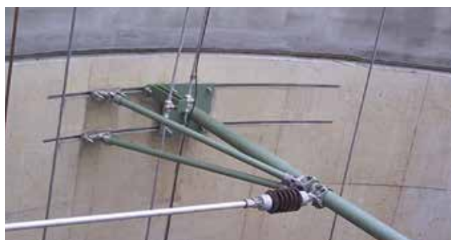
Bevestiging van de bovenleiding in een spoortunnel
