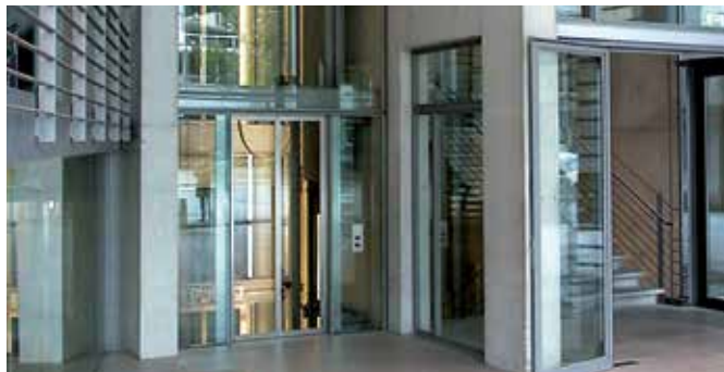
Geleiderail bevestiging in een liftschaft
