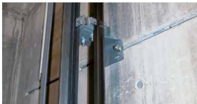
Geleiderail bevestiging in een liftschacht
